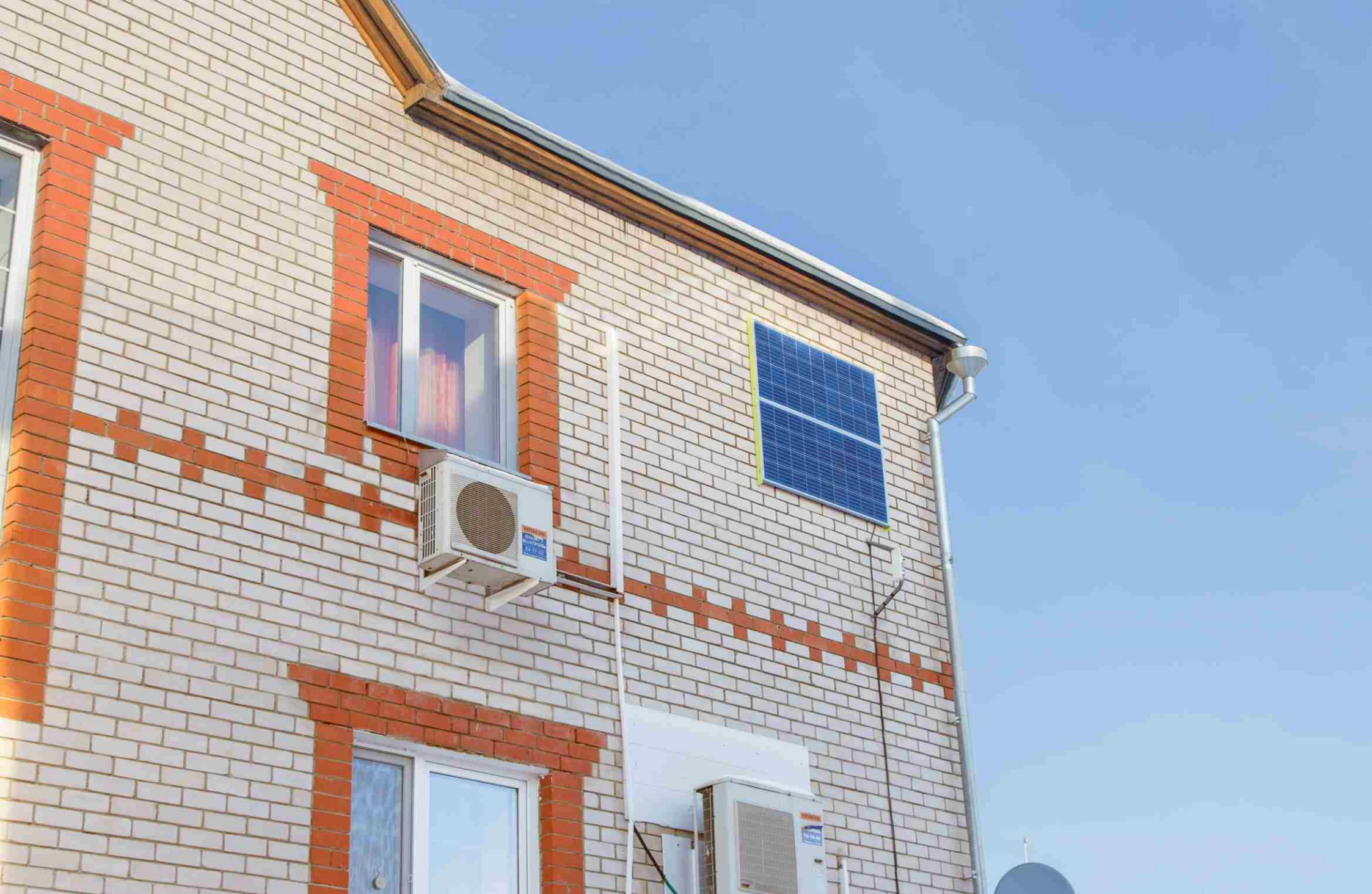
Установленная солнечная панель мощностью 300 Вт
