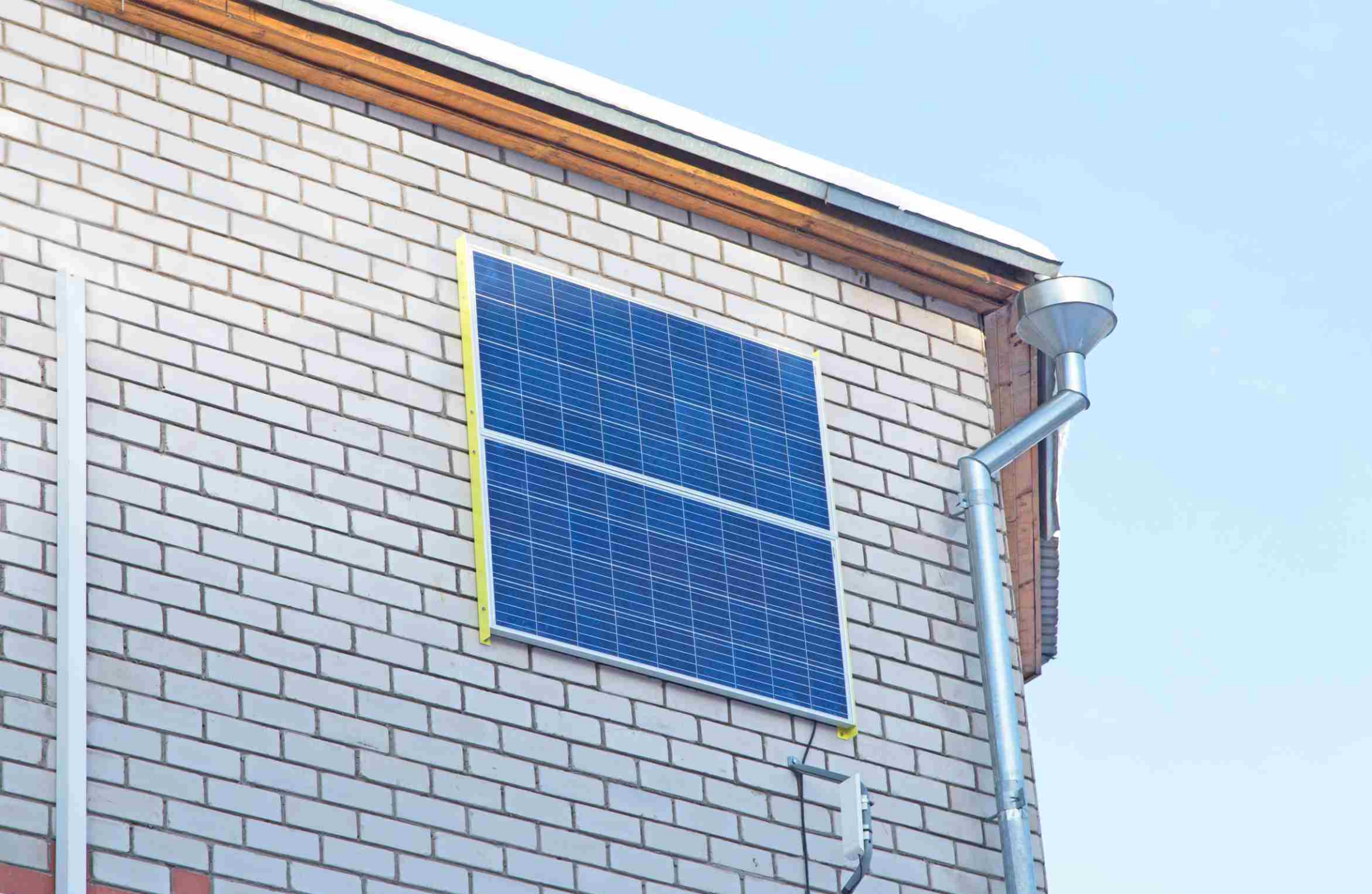
Установленная солнечная панель мощностью 300 Вт
